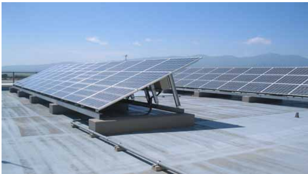
太陽光パネル
